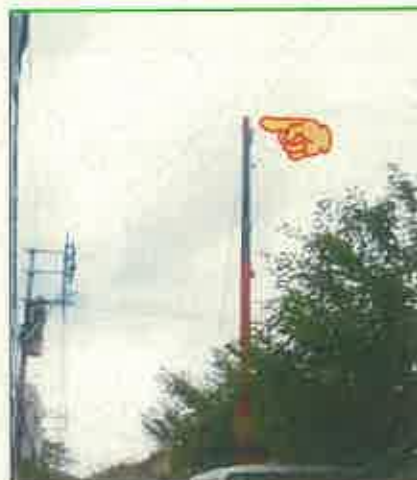
【クレーンが高圧線に接触】
