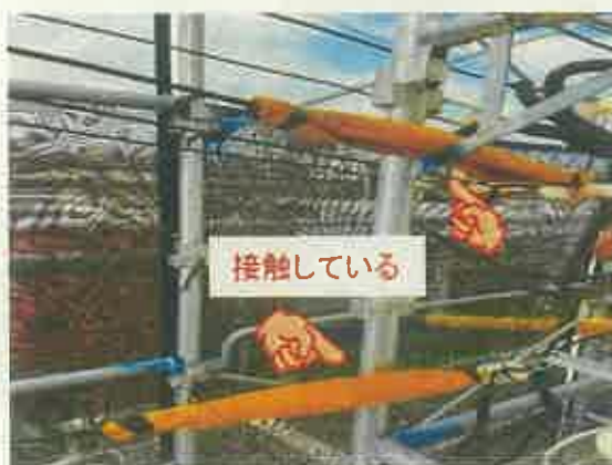
【足場と接触させない】
