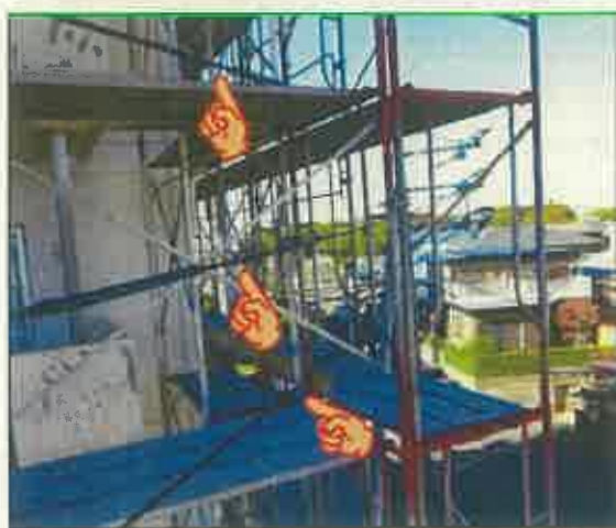
【足場が高圧線を貫通】
