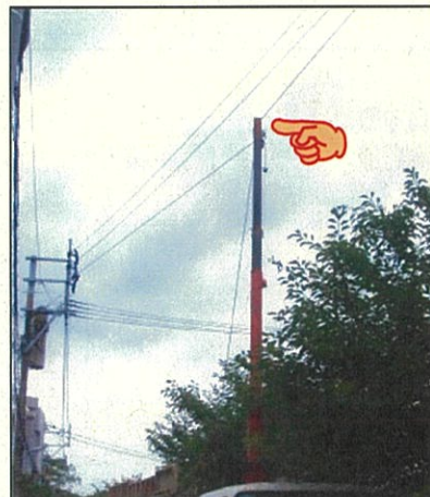
【クレーンが高圧線に接触】
