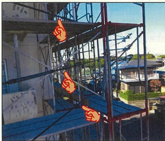
【足場が高圧線を貫通】
