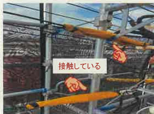
【足場と接触させない】
