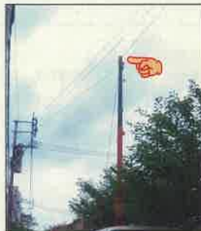
【クレーンが高圧線に接触】
