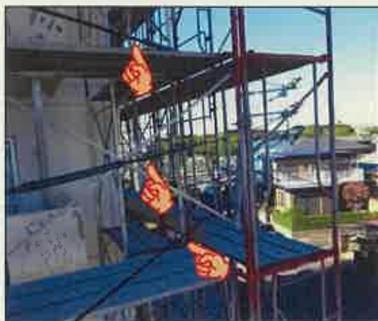
【足場が高圧線を貫通】
